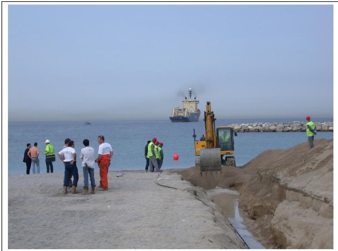
Pose du câble Atlas Offshore sur la place du Prado (G. Fouchard)
